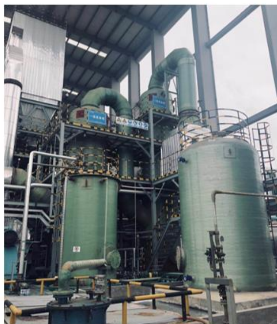
图 4.2-3 脱酸塔+中和塔
