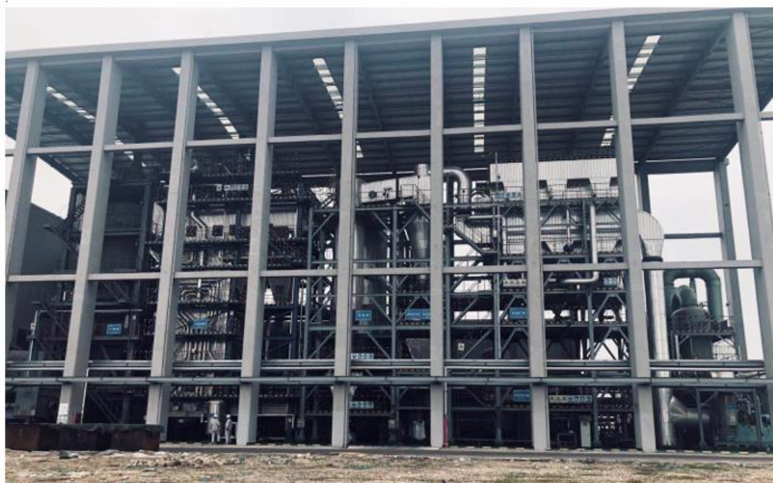
图 4.2-1-- 固废焚烧系统全貌
