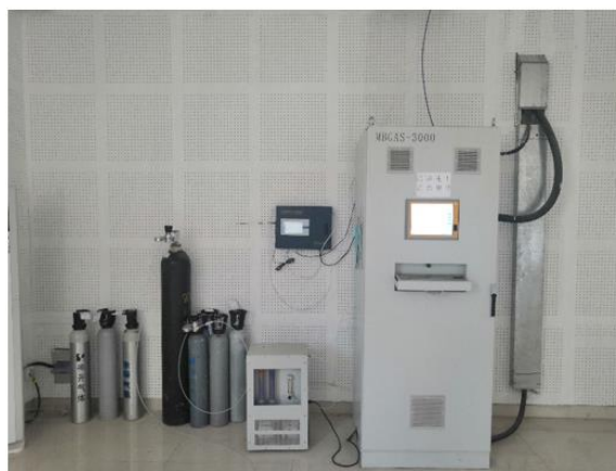
4.2-12 废气在线监控设备
