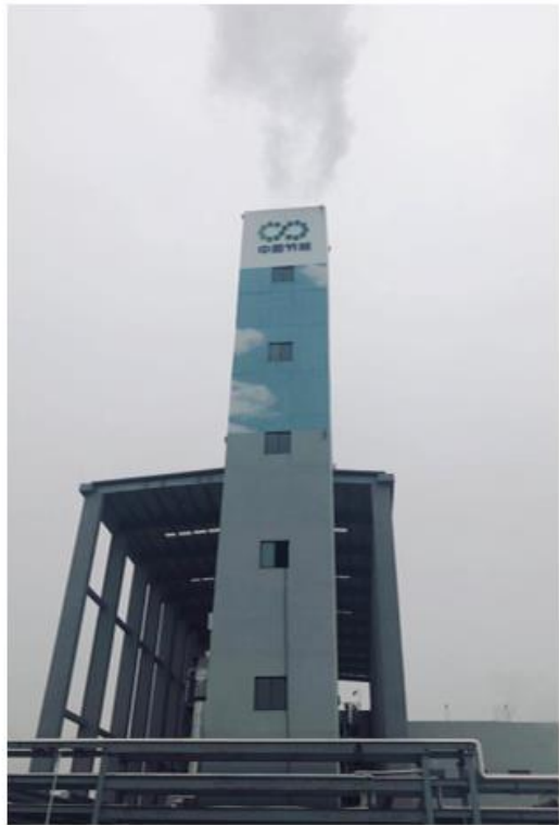
图 4.2-5 焚烧系统 50 米排气筒
