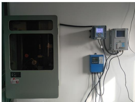
4.2-11 废水在线监控设备
