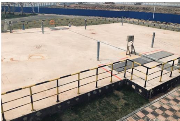
图 4.2-9 雨水池、事故池
